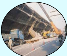
神戸 / 高架橋の倒壊
