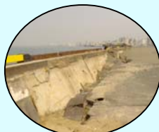
福岡 / 防波堤後背地の地盤沈下
